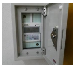
【談話室のエアコン操作盤】
