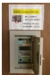
【宿泊室のエアコン操作盤】
