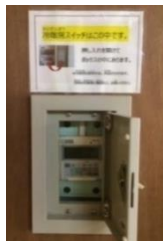
【宿泊室のエアコン操作盤】
