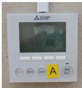
【プレイホール・研修室の エアコン操作盤】
