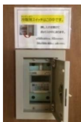
【宿泊室のエアコン操作盤】
