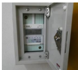
【談話室のエアコン操作盤】
